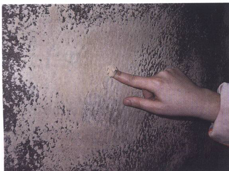
Figura 4 - Uma das patologias frequentes em reservatórios de água - A má qualidade dos revestimentos.
