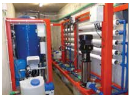
Sistema de tratamento de água, composto por sistema de ultra filtração e sistema de osmose inversa. Hipermercado Kero - Luanda
