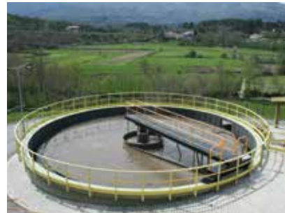
Estação de tratamento de águas residuais.
