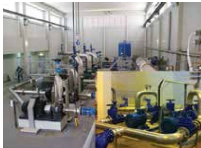
Estações elevatórias de abastecimento de água Ondjiva - Cunene
